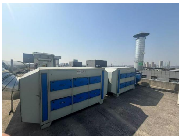
楼顶滤筒除尘+二级活性炭吸附装置
